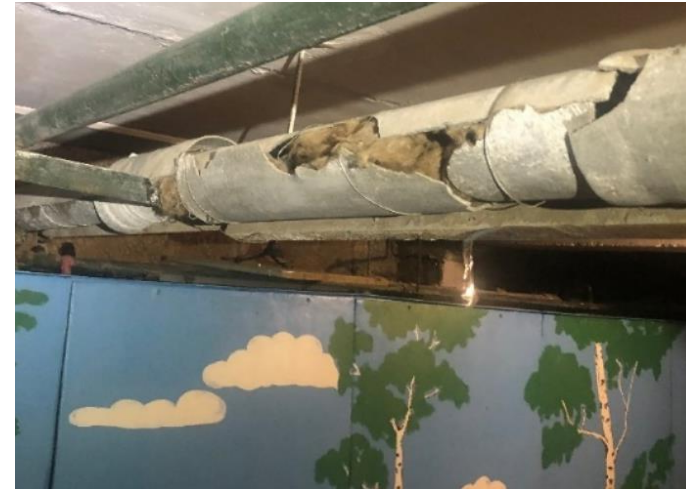
Рис. 9 Приклад АВМ в приміщенні шкільного підвалу, яке використовується, як укриття в м.Харків
