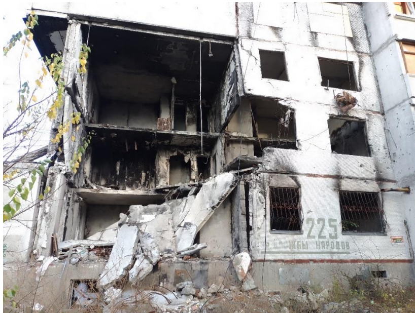
Рис. 2 Фрагмент зруйнованої, внаслідок воєнних дій, частини багатопверхового великопанельного житлового будинку
