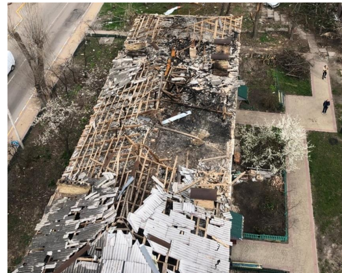
Рис. 10 Наслідки руйнувань будівель з АВМ після військових дій в м. Ірпінь
